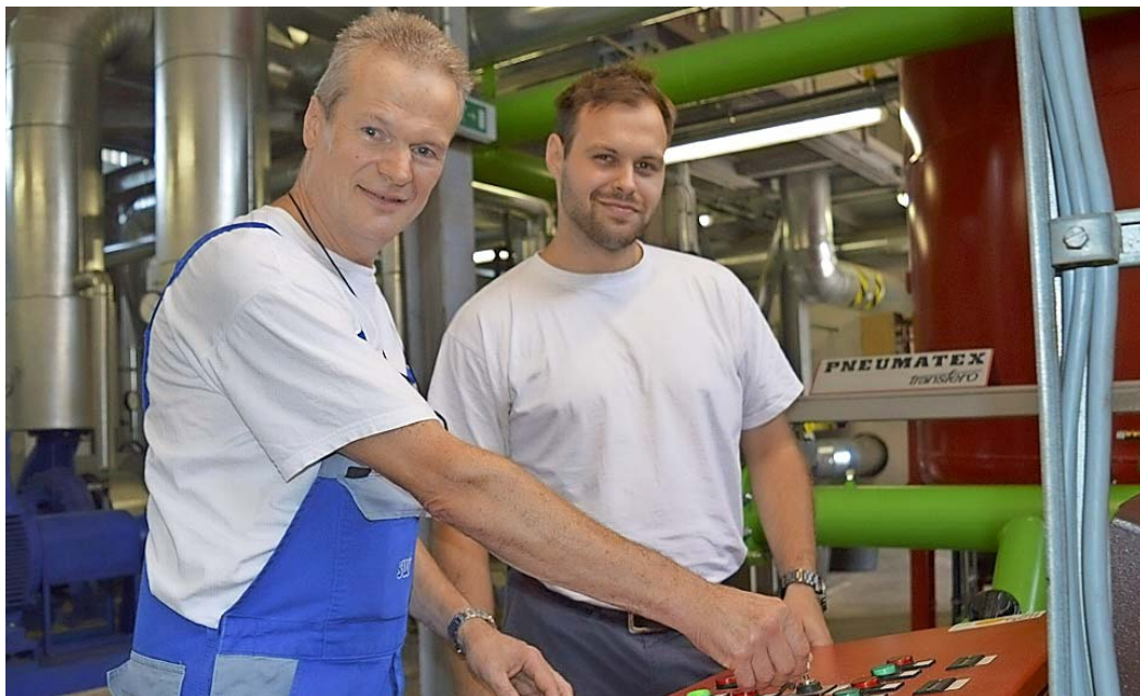
Manfred Klenner und Chris Neumann im Maschinenraum der Fernwärmekoppelstation am Stadtrand von Weißwasser. Dort wird die Fernwärme aus Boxberg auf das Stadtgebiet verteilt.
